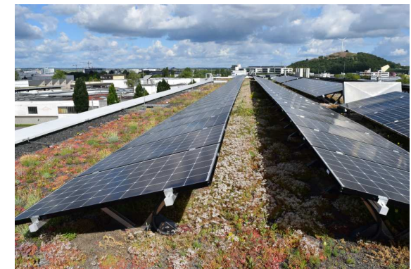
Beispiel für ein Photovoltaik-Gründach
