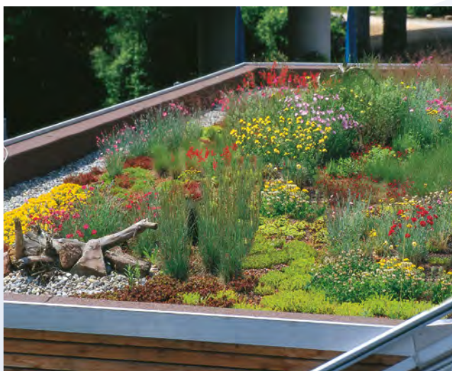
Farbenfrohe Bepflanzung einer extensiven Dachbegrünung am Beispiel eines Carports [Bild: DDV]
