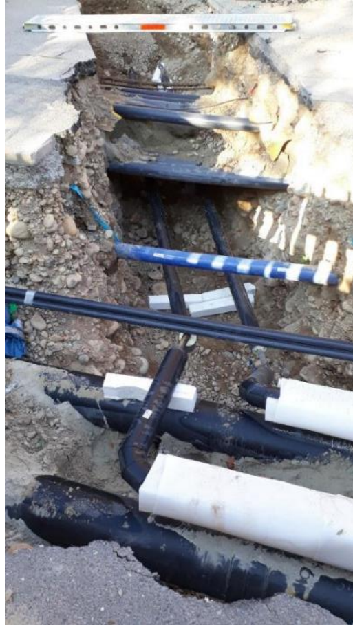
Teilweise Unterschreitung der Mindestabstände
