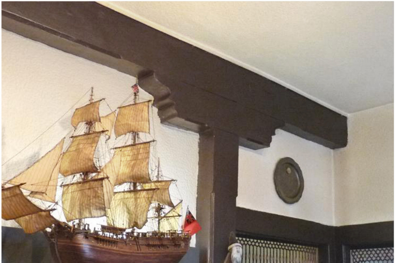
Mittlerer Eingang, Wohnung im Erdgeschoss rechts: Gefaste Stütze unter Längsunterzug mit Sattelholz im östlichen Zimmer an der vorderen Traufseite
