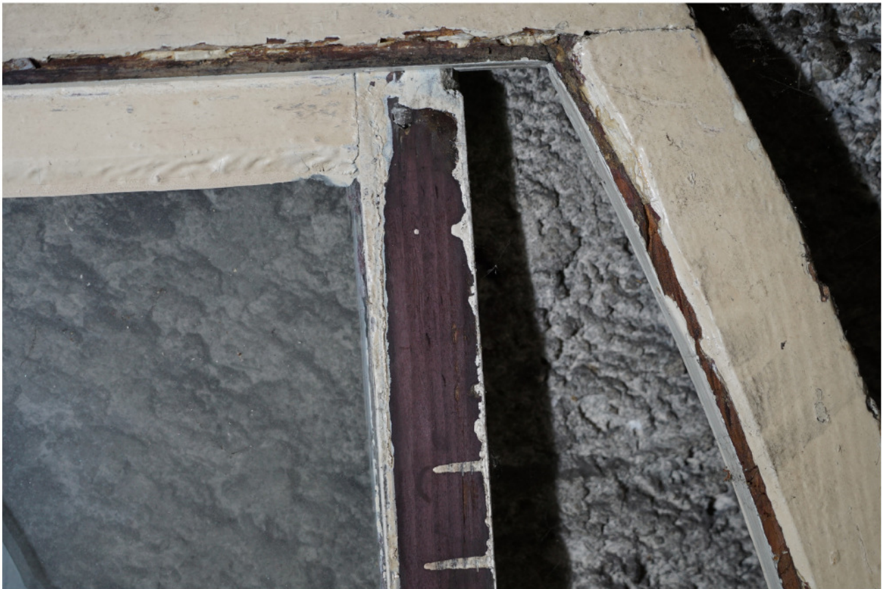
Wie Abb. 25, früherer Anstrich in Rotbraun an der beim Neuanstrich nicht zugänglichen Rückseite eines der Schieberemente
