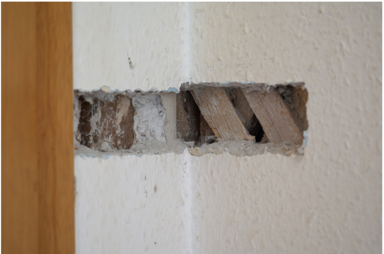
Rechter Eingang, Wohnung im Obergeschoss links: Sondage zum Aufbau der mittigen Längswand aus mehrlagig überkreuz vernagelten Latten im Anschluss an die zentrale Stütze
