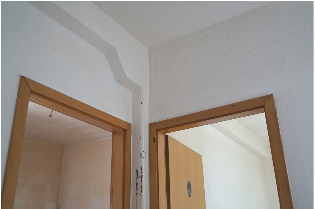
Rechter Eingang, Wohnung im Obergeschoss links: Zentrale gefaste Stütze unter Längsunterzug mit einem unter Verkleidung verborgenem Sattelholz 14
