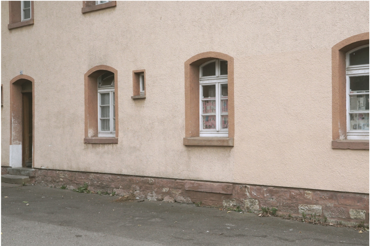
Vordertraufe: drittes Fenster von rechts mit vorstehender Türschwelle innerhalb des Sockelbereichs unterhalb
