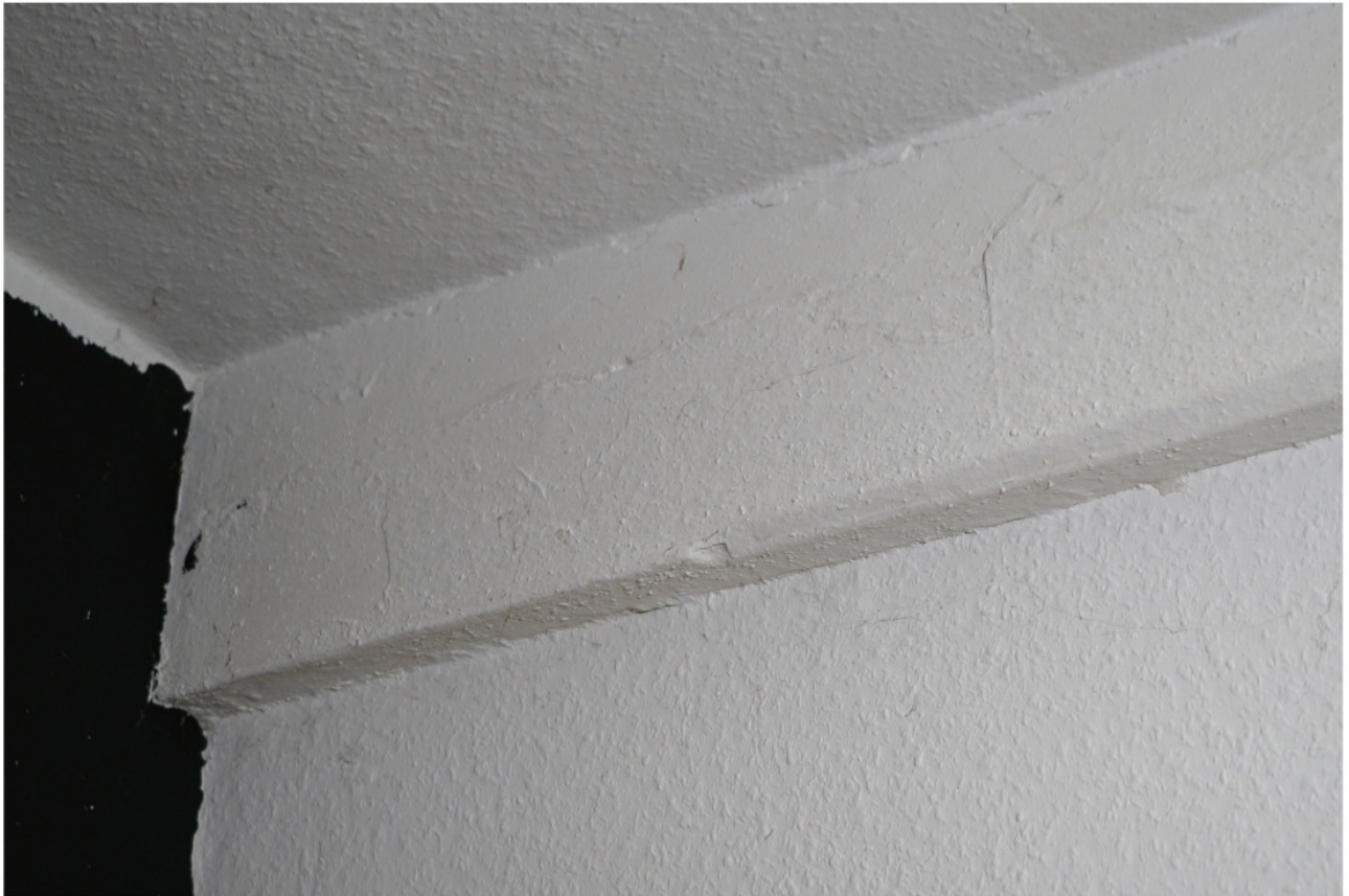
Wohnung linker Eingang Erdgeschoss: Fasenauslauf am Längsunterzug westlich der Trennwand zum Flur
