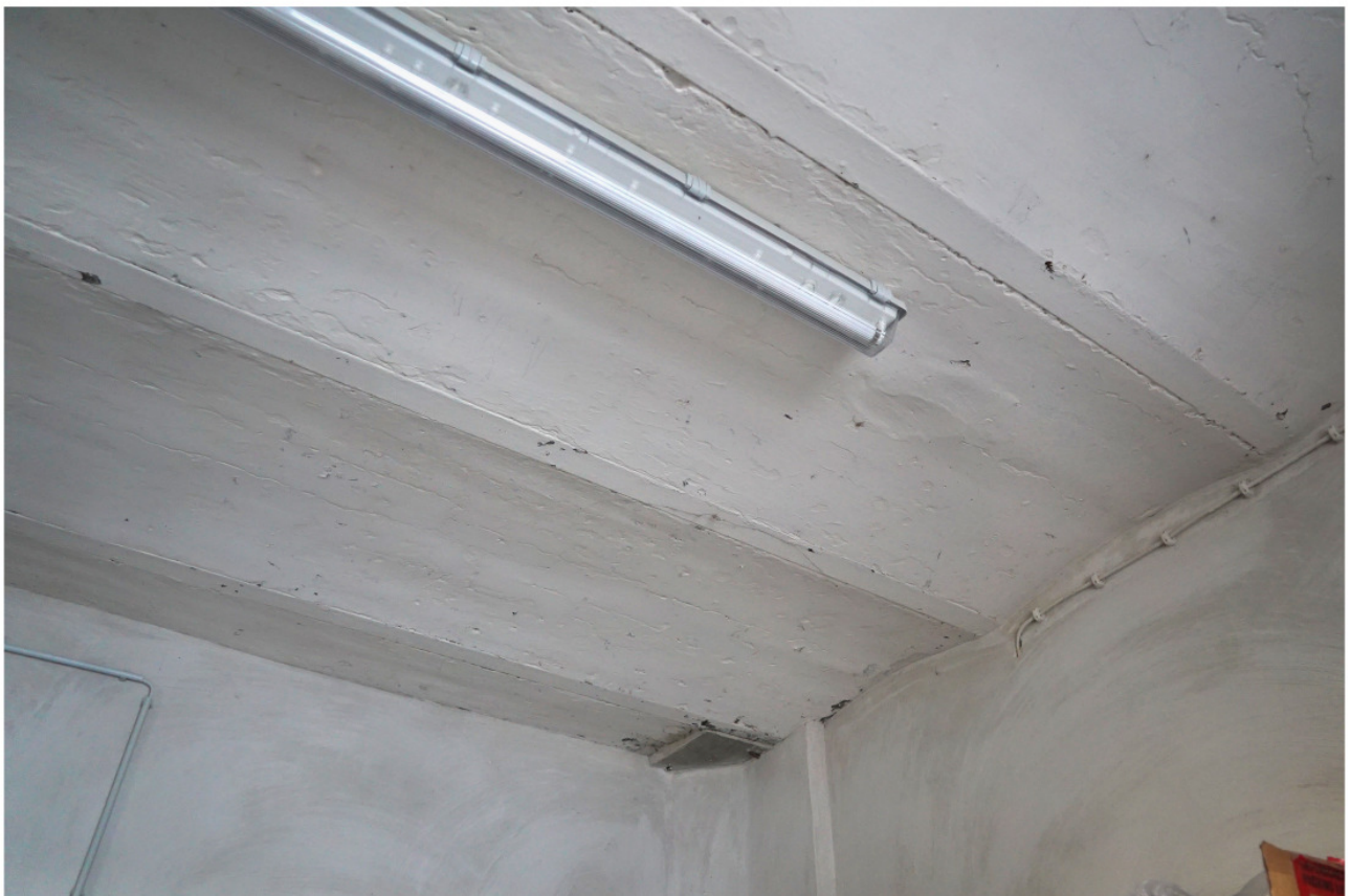
Decke im nördlichen Erdgeschossraum aus Eisenträgern und Stichkappen aus Backstein; in der Ecke Fehlstelle eines vormals vorstehenden Kamins
