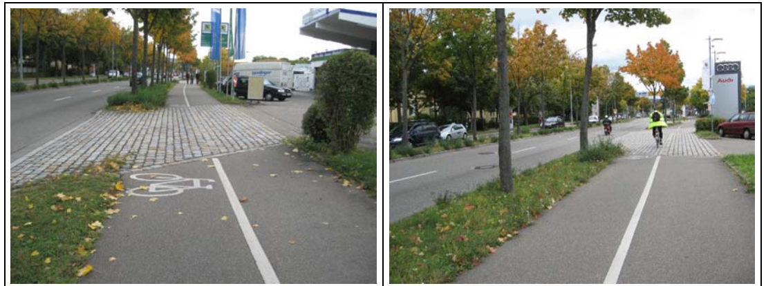
Bild 9-3: Belagsunterbrechung an Grundstückszufahrten
