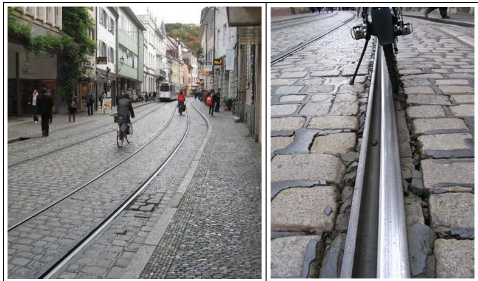
Bild 3-2: Pflasterschäden im Bereich Salzstraße
