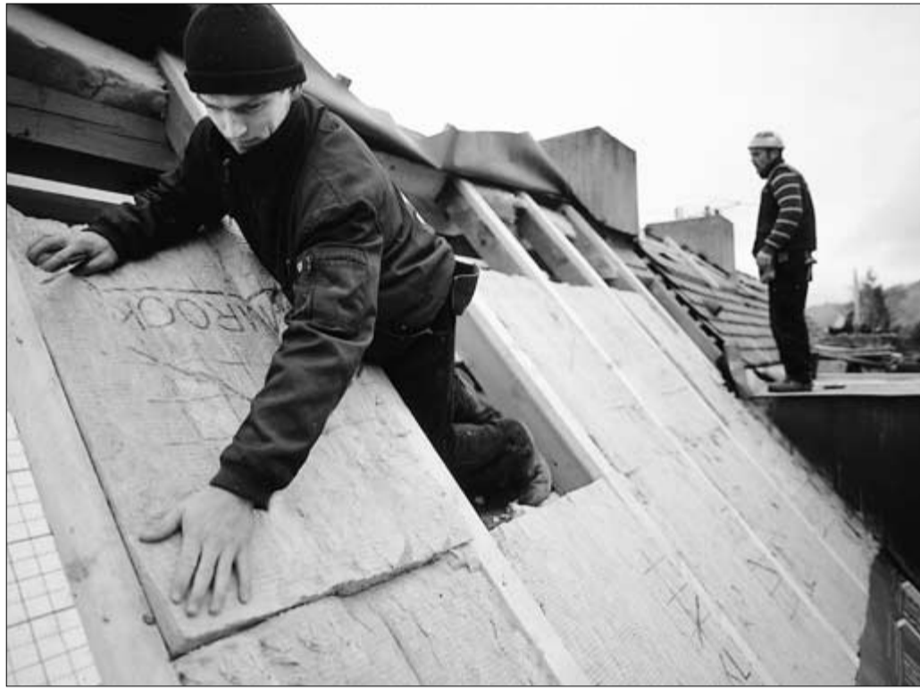
Die Mehrkosten für eine effektive Wärmedämmung des Daches sind vergleichsweise niedrig, wenn ohnehin eine Dachsanierung ansteht (Foto: Energieagentur)
