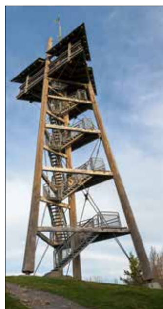
Jahrgang 1980: Der Holzturm ist in die Jahre gekommen.
