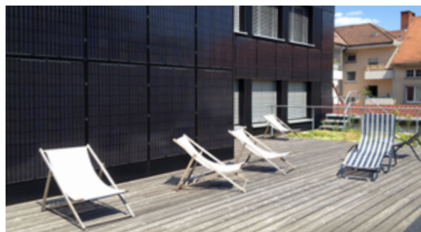
Photovoltaik an der Fassade
