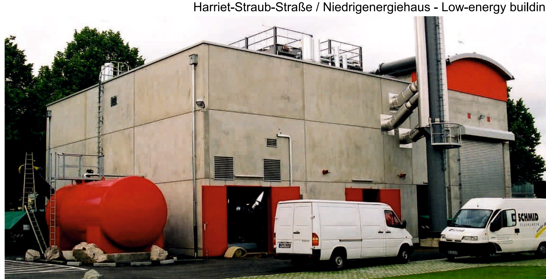
Blockheizkraftwerk mit Holzhackschnittelheizung - Block-type thermal power station
