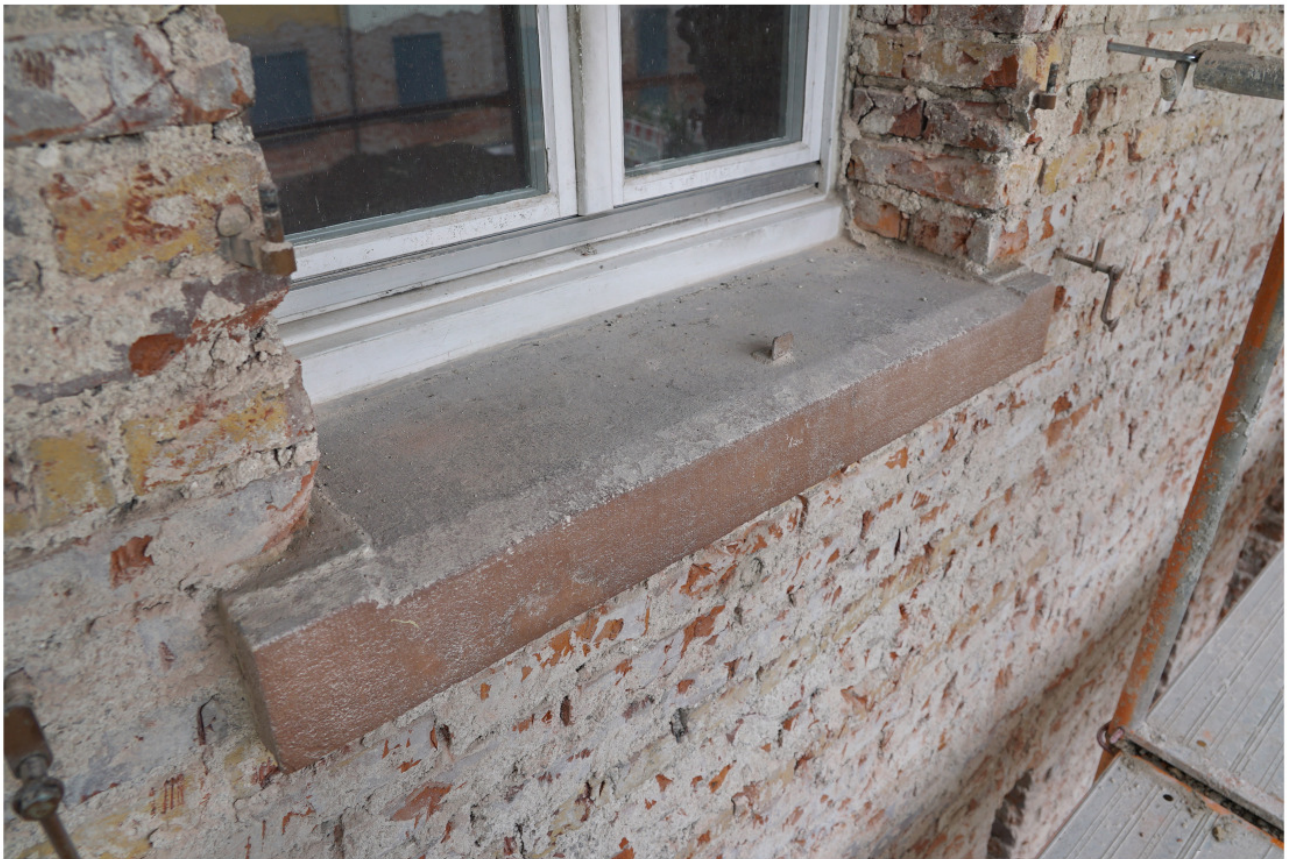
Nr. 70: vorretende Fensterbank aus Buntsandstein an obergeschossigem Fenster der Ostseite mit mittigem Anschlagstutzen für die Fensterläden
