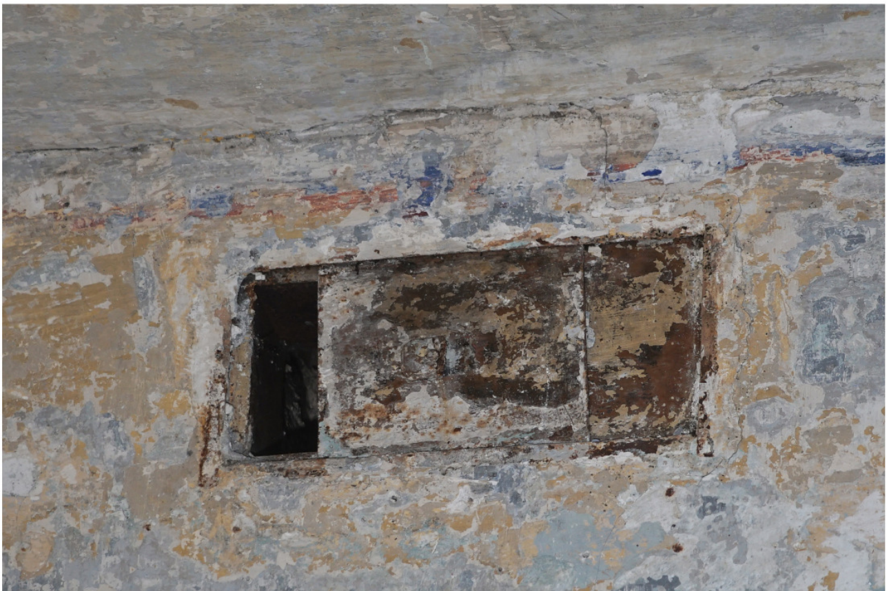
Nr. 76 L: Blechschieber zum Lüftungsschacht des Erdgeschossraums, teilweise geöffnet
