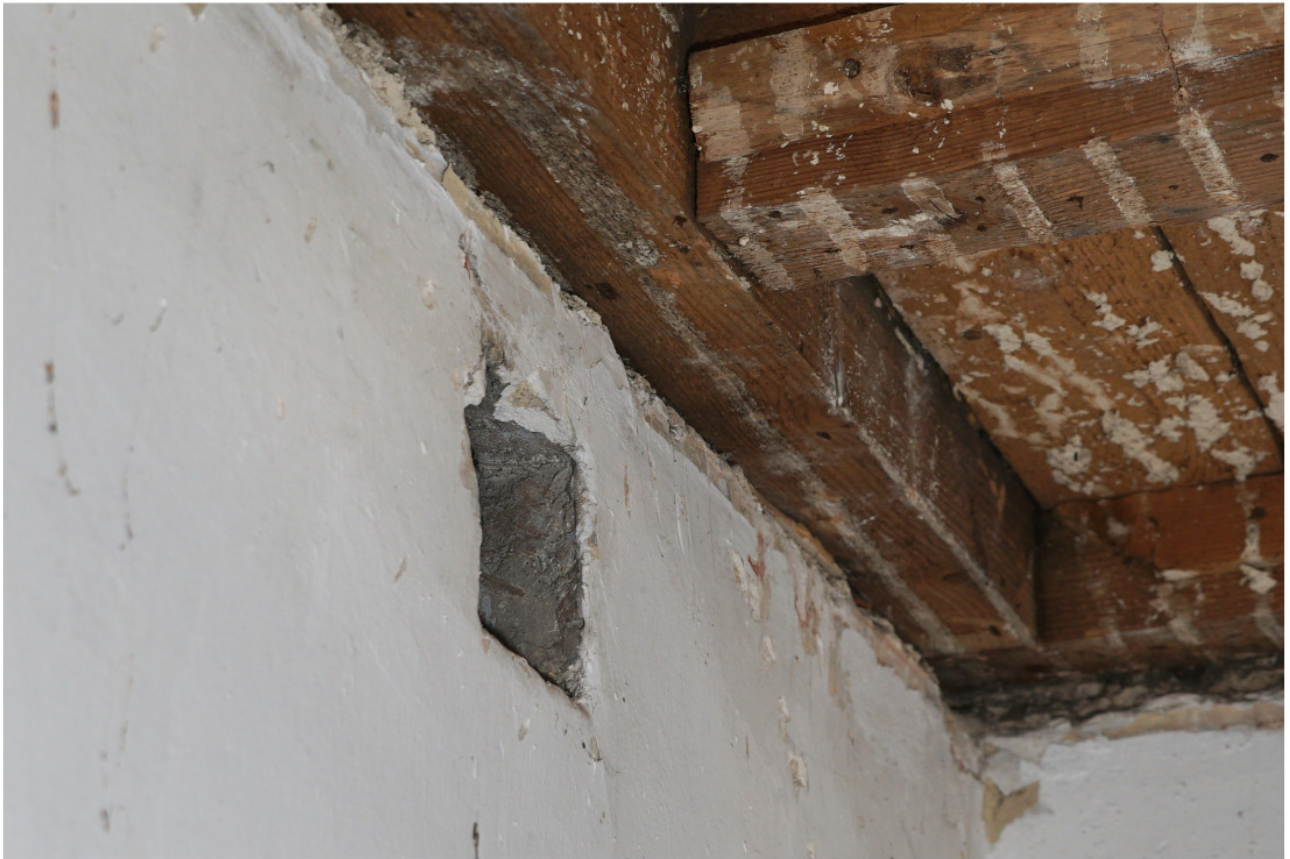
Nr. 76 a: unverschließbare Lüftungsöffnung hoch über der Geschosstreppe und Wechsel innerhalb des Dachgebälks
