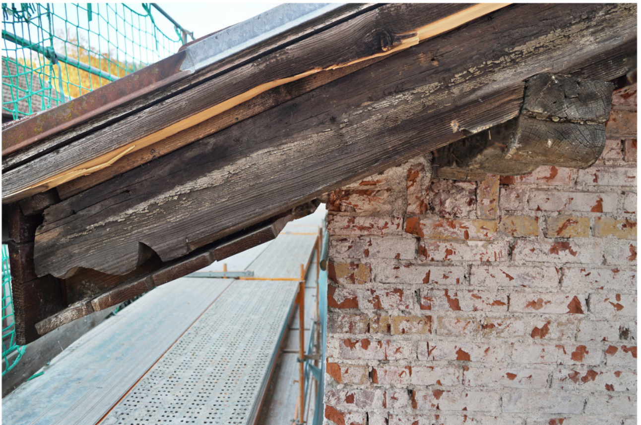
Nr. 70: beschnittenes Sparrenende an der Südwestecke, anhand des Rands der Fassung zeichnet sich ein einstamls aufgenageltes Ortgangbrett ab
