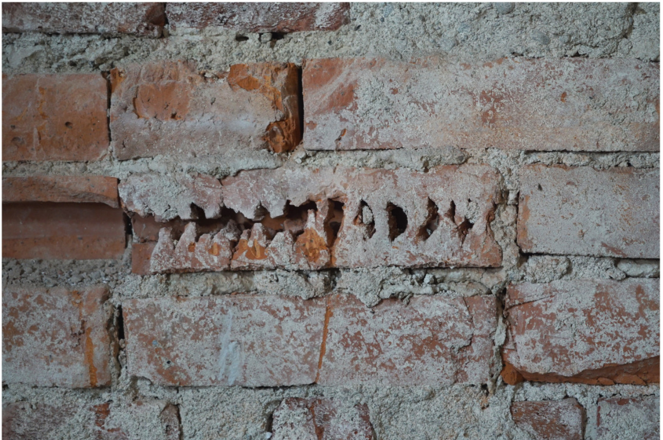
Nr. 70: Backstein mit aufgerissener Längsseite vom Einstanzen der Längslöcher
