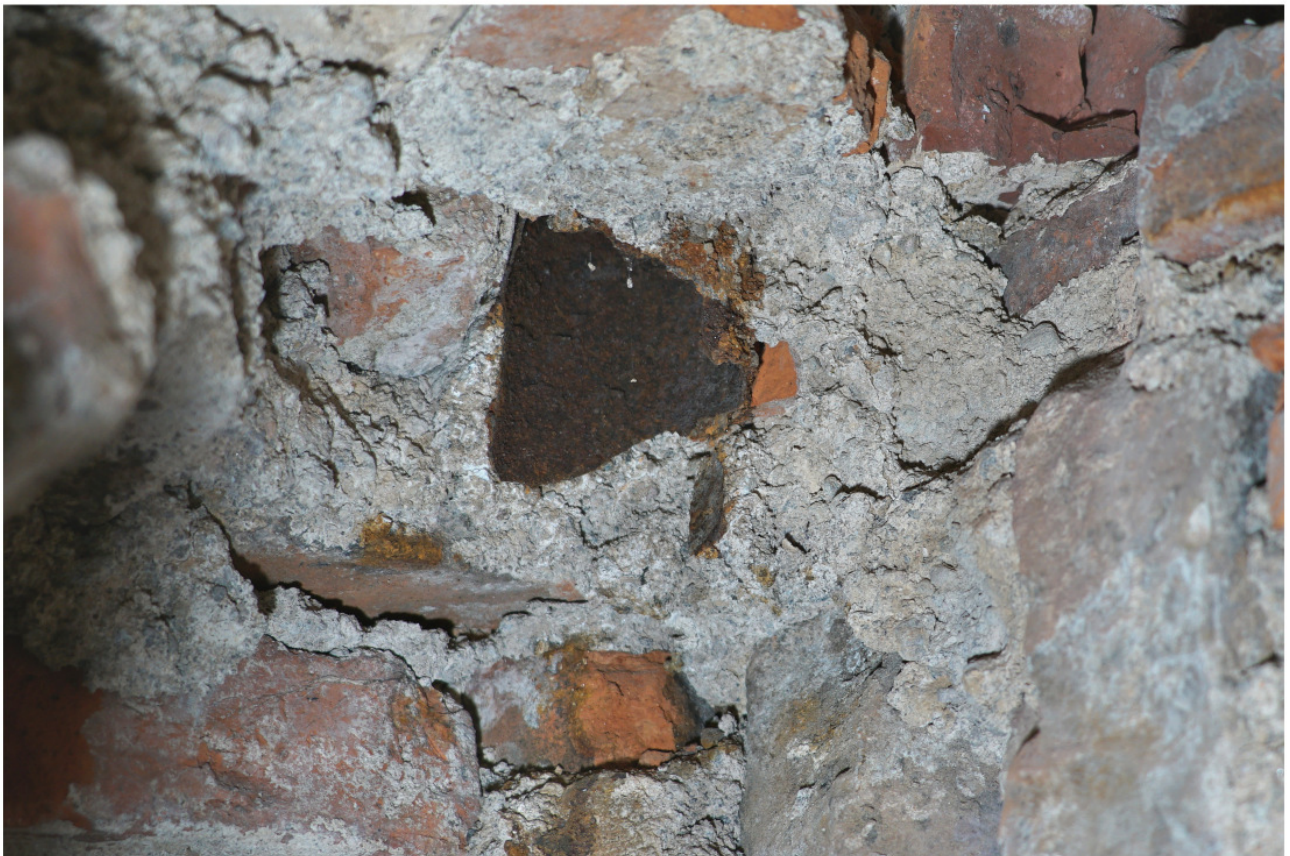
Nr. 70 k/L: unteres Ende des Lüftungschachts der Aborte mit verrostetem Blechrohr, freigelegt im Durchbruch für die neuerlichen Installationen
