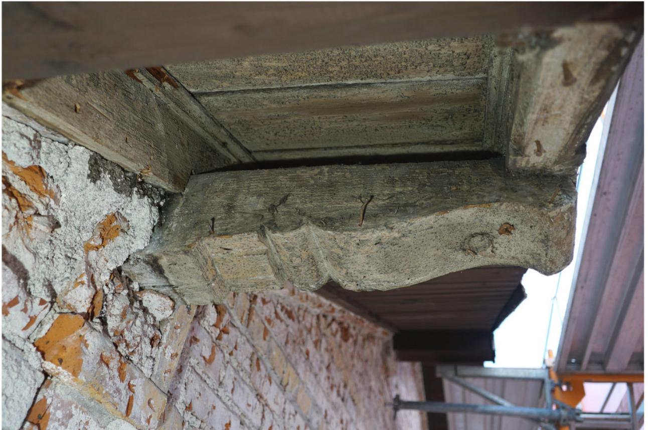
Nr. 70: vorkragende beschnittene Traufschwelle an der Südwestecke, Ortgangverschalung auf profilierten Randleisten zwischen den Sparren, graugrüne Fassung der Holzteile
