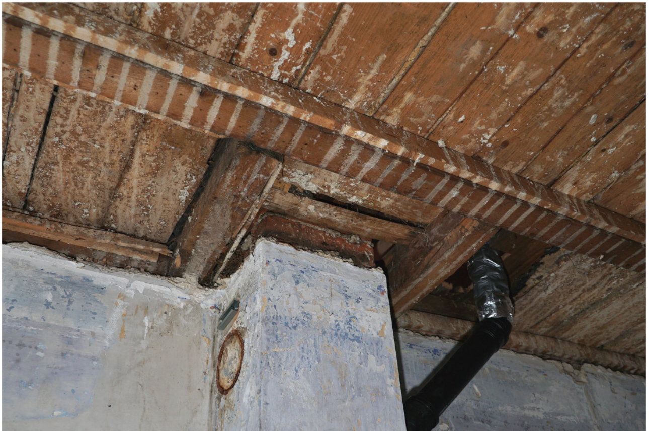
Nr. 76 d: Wechsel am Kamin in der Dachbalkenlage ohne eine Verwahrung wie bei Nr. 70 (mit neuen Installationen)
