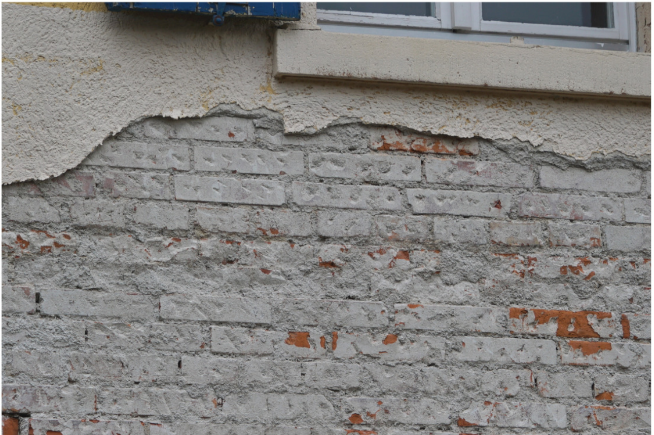
Nr. 70 f: Abgeschlagenes Gurtgesims aus ehemals zwei vorkragenden Steinlagen
