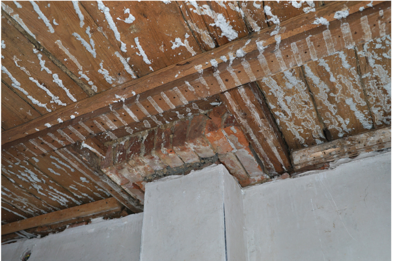
Nr. 70 a: Wechsel am Kamin in der Dachbalkenlage mit Verwahrung aus Backsteinen in der Form eines scheinrechten Bogens
