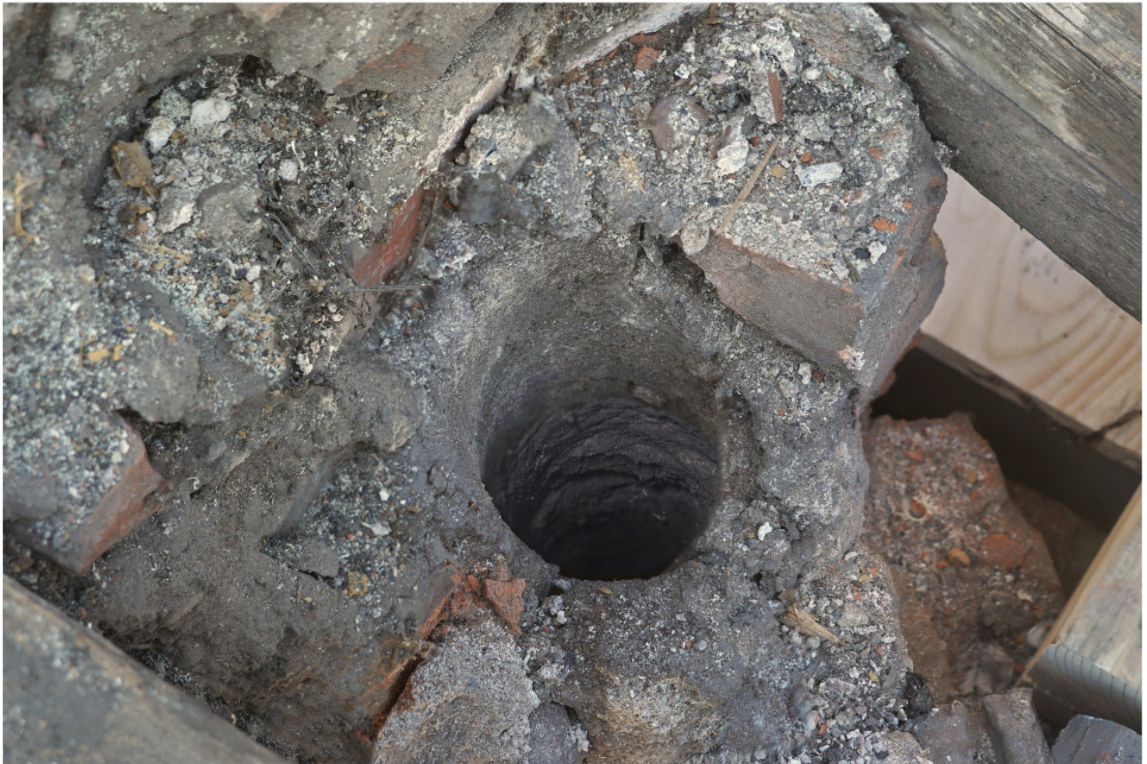
Nr. 76 k/L: oberer Austritt eines Lüftungschachts der Aborte in der Mauerkrone wo Außenwand und querlaufende Scheidewand zusammentreffen (bei abgenommener Dachdeckung)
