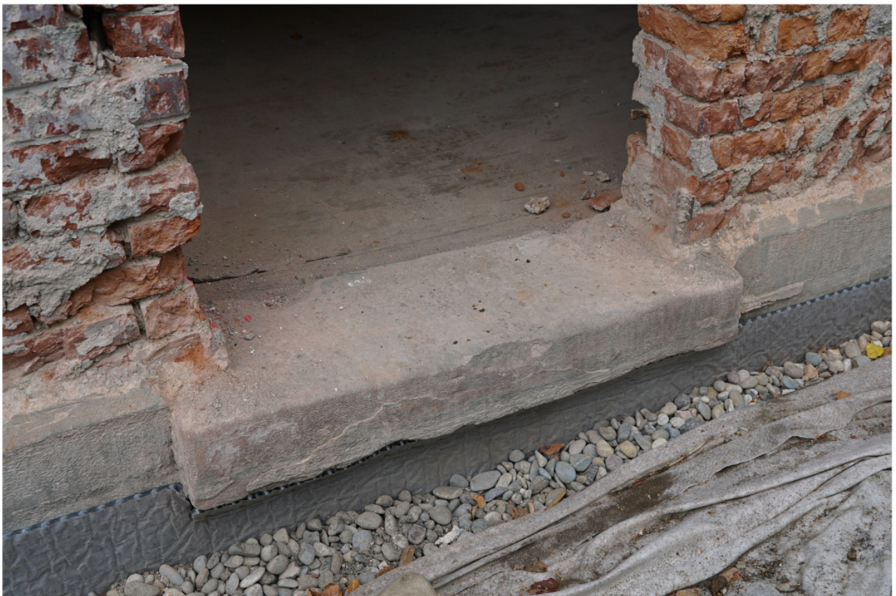
Nr. 76m: vorretender Schwellstein der Haustür aus Buntsandstein, eingebunden in Sockelmauer aus Werksteinquadern
