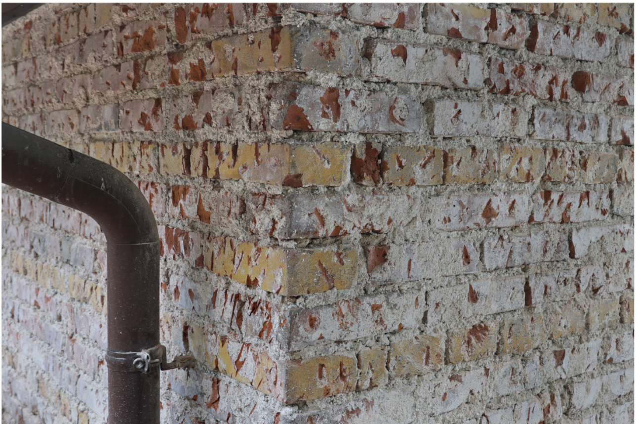
Nr. 70: Nordostecke mit Ockerfassung auf jedem zweiten Eckstein mit Längsseite an der Traufseite und Fortsetzung derselben in jeder vierten Steinlage
