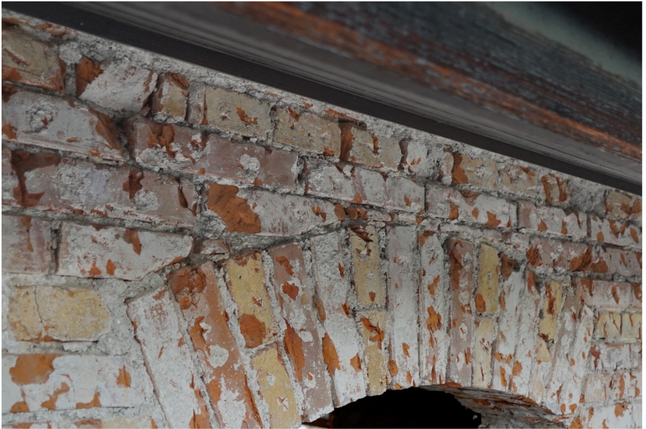
Nr. 76 a: Ausbrüche abgeschlagener Konsölchen unterhalb der Sparren und Ockerfassung dazwischen, Fensterbogen mit jedem dritten Stein in Ocker und drei ungefassten im Scheitel
