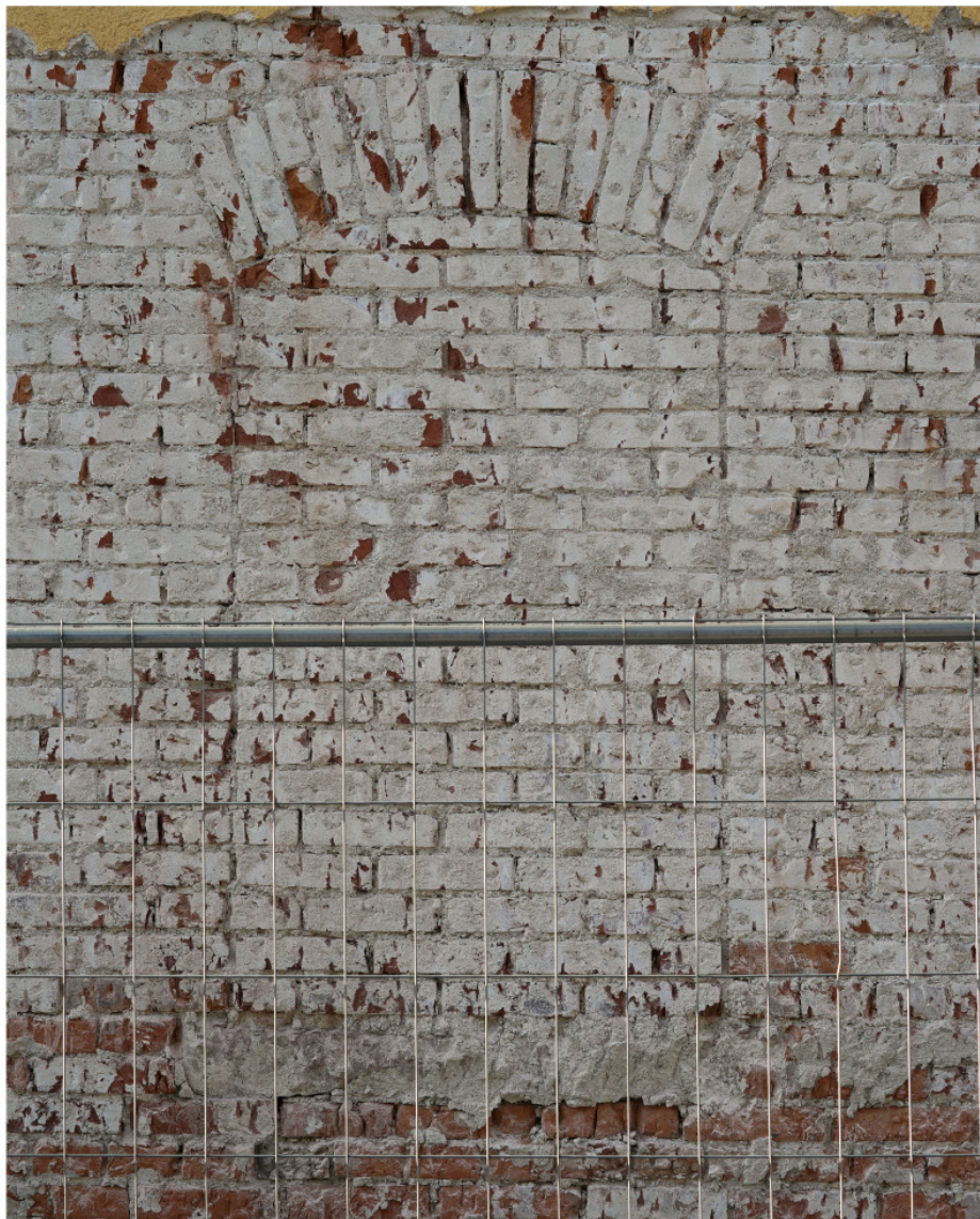
Nr. 76: Scheinfenster an südlicher Giebelseite links, abgeschlagene Fensterbank aus Werkstein, Fugen in Steinlagen, Stichbogen 8
